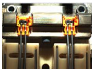
ケーブルアセンブリが正しく 設置されているかの検証
